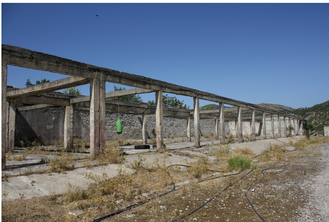
Figura 01: Një forografi e bërë nga autorja në gusht 2018, ku paraqitet armatura dhe mbetjet e betonit të një ndërtese në ish-kampin e Tepelenës.
